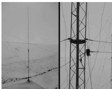
Antenas instaladas por UV para las activaciones.
